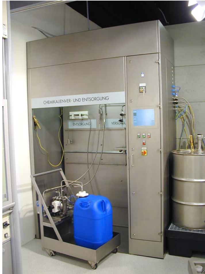
Stazione di travaso per liquidi infiammabili
